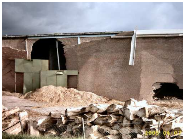
Bouwval als bedrijfsgebouw
